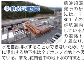
⑩ 排水処理施設 瑞浪超深地層研究所は、岐阜県及び瑞浪市と締結している環境保全協定に則り、排水処理施設により濁度及び水素イオン濃度の調整のほか、ふっ素とほう素を除去して近隣の河川に放流している。排水処理施設は、1日に最大1500m 3 の処理能力をもつ。
