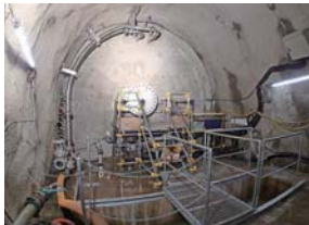
⑤ 500m冠水坑道 坑道閉鎖時の地質環境の回復現象の把握などを目的とする再冠水試験用坑道。入口に50気圧の耐圧性能をもつ止水壁を設置している。
