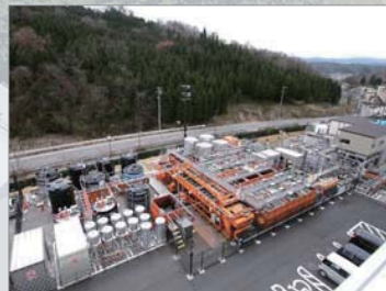
ふっ素・ほう素の除去機能が付加された排水処理プラント
