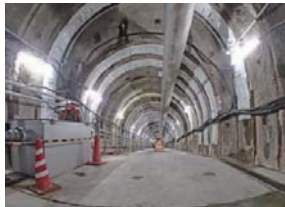
④ 500m研究アクセス北坑道 本坑道は、長さ161.4m、高さ4.5m、幅5m。先端約40mは冠水坑道としており、冠水坑道とは傾斜10%の斜坑で結ばれている。
