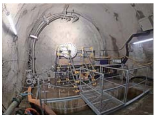
図15 冠水坑道に設置された止水壁
